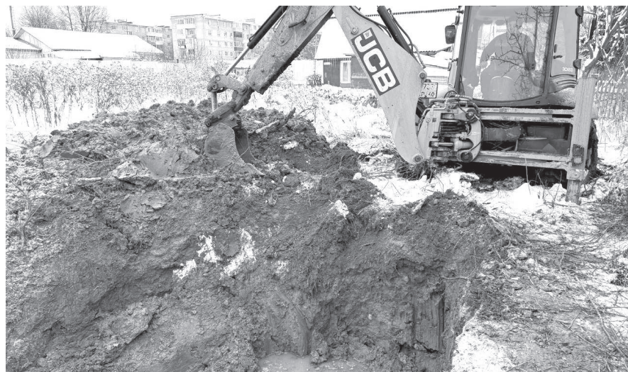
Причиной аварии на улице Комсомольской стала изношенность трубы холодного водоснабжения
