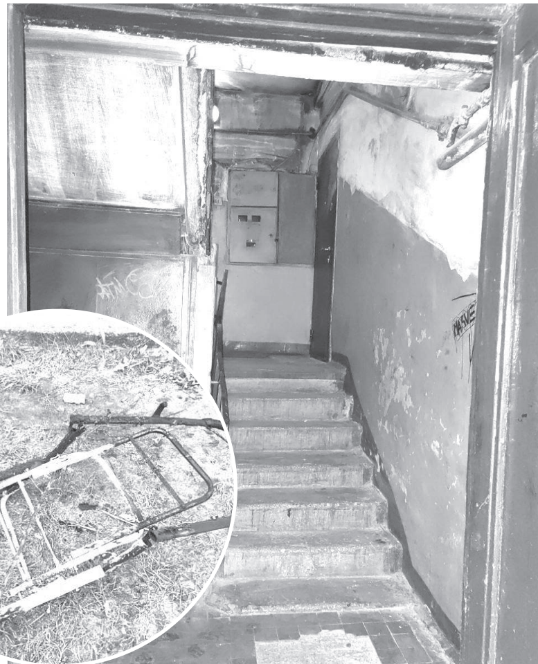
Сотрудники УК отмыли подъезд от гари и копоти, а коляска восстановлению, увы, не подлежит
