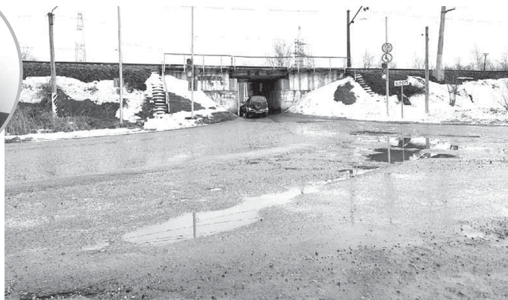
Дорожное покрытие внутри балабановского тоннеля ремонтируют ежегодно, но колеи и ямы в асфальте образуются вновь и вновь
