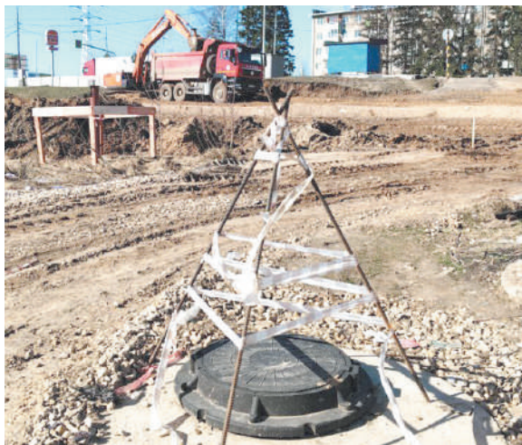
Дорожники огородили люки после их неоднократного повреждения строительной техникой
