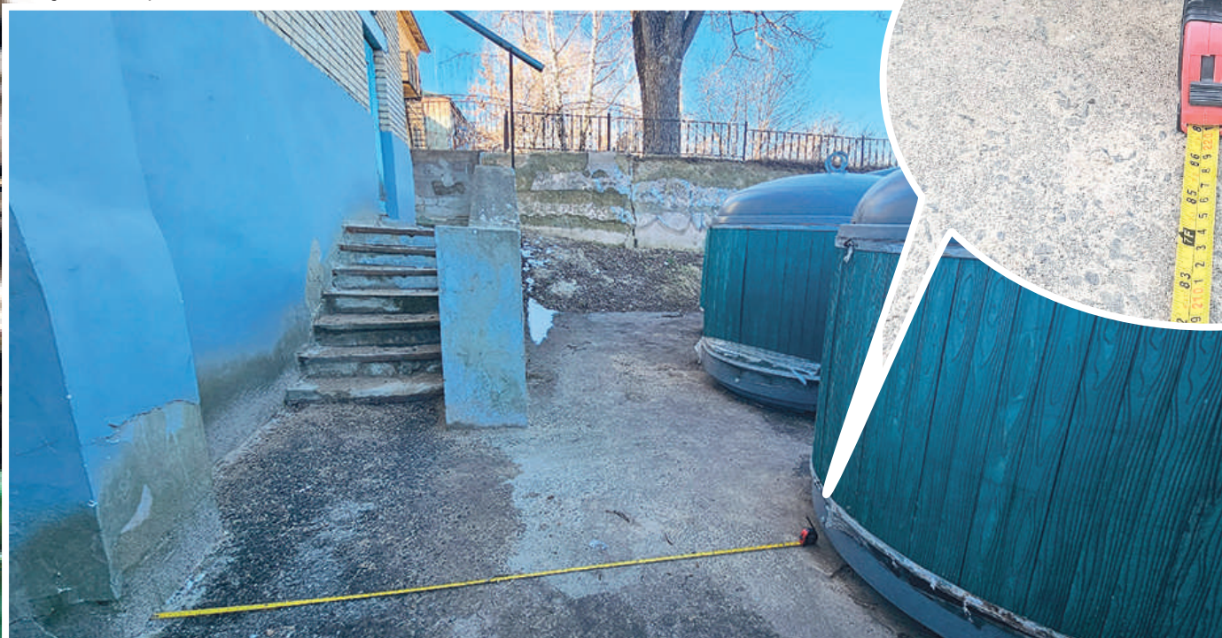
При установке «куполов» за домом на площади Ленина, 1 забыли про нормы СанПиН. Расстояние от баков до пятиэтажки всего 221 сантиметр. Вряд ли это нравится жителям первого и второго этажей
