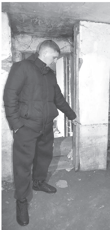
Подтопление подвального помещения выше 50 см
