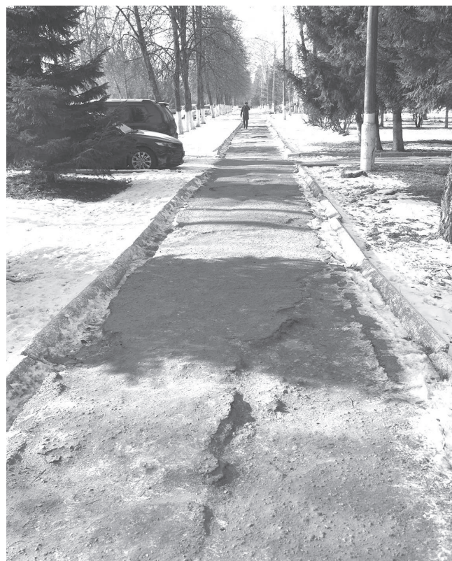
Для ремонта тротуара требуется передача земли в город
