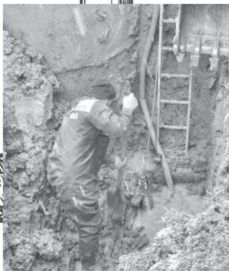
От постоянных порывов страдают и жители, и рабочие ресурсоснабжающей организации, которые практически не выезжают из коммунальных окопов
