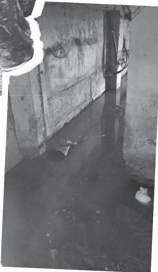
Осушить и обработать подвал региональная Госжилинспекция пообещала до конца следующей недели
