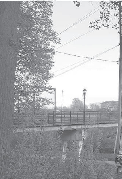
Канунников мост получит усиленные бетонные опоры и обновлённые металлические детали. На модернизацию пешеходной переправы из бюджета выделят десять миллионов рублей
