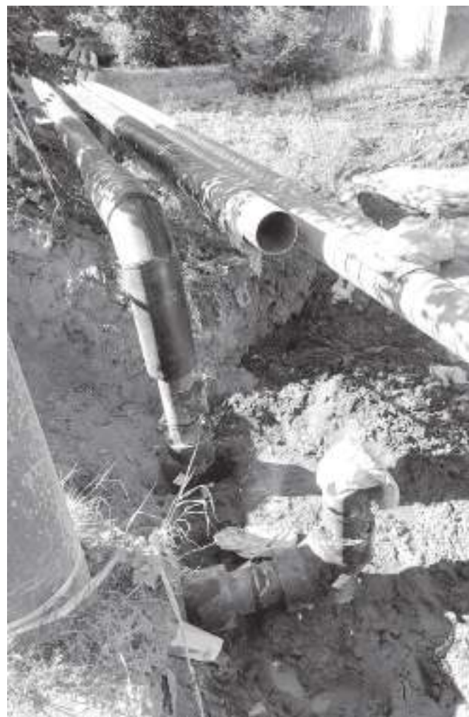
В этом году удалось «спрятать» часть труб, сократив теплопотери
