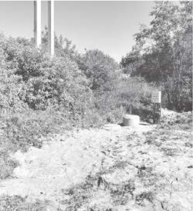
Канализационно-насосная станция уже работает на полную мощность. Теперь осталось оформить технический проезд для её обслуживания
