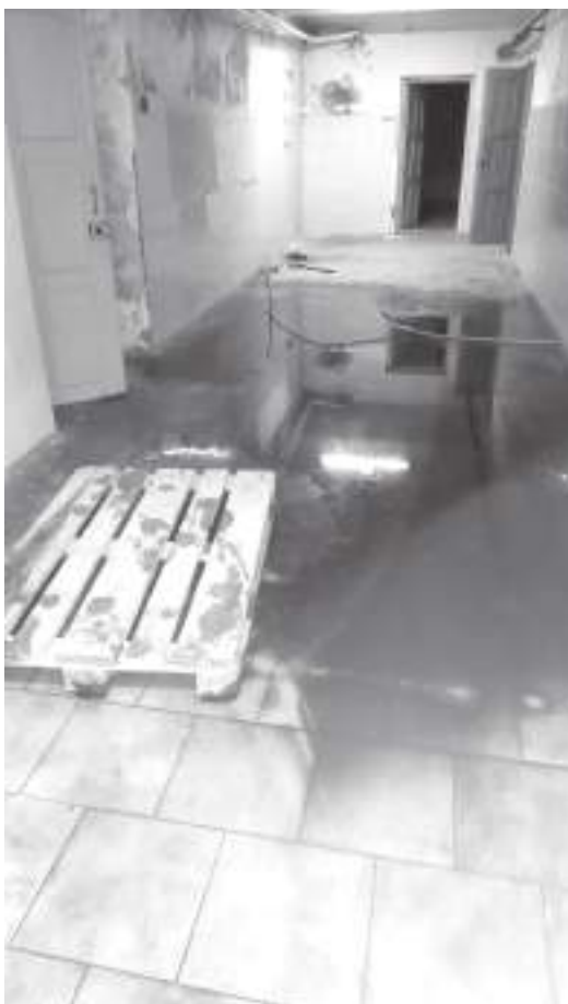
Дырявая крыша приводит к очевидным последствиям
