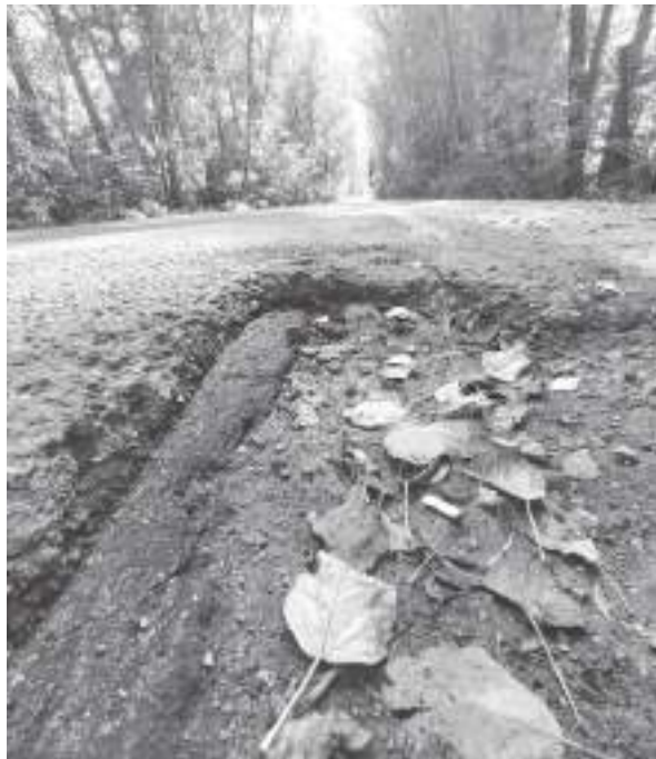
Обочины укрепляли в рамках ямочного ремонта, но его хватило ненадолго. Дорога потихоньку разваливается
