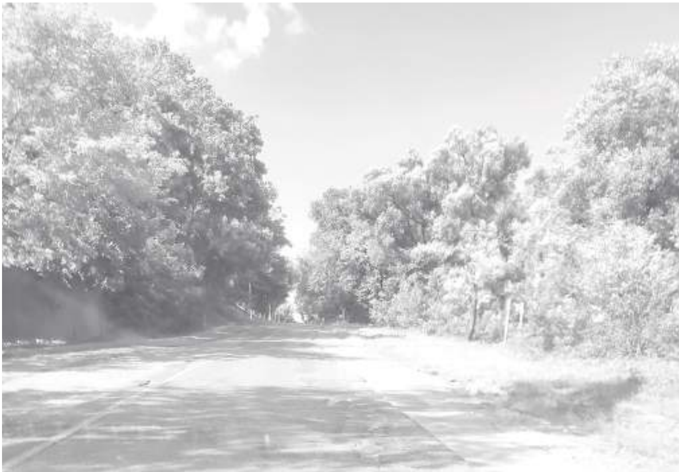
Улица Ленина разбита настолько, что ямочный ремонт лишь превращает покрытие в стиральную доску
