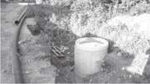
Установленные канализационные колодцы, скорее всего, придётся переделывать. Как и осыпающееся асфальтовое покрытие дороги
