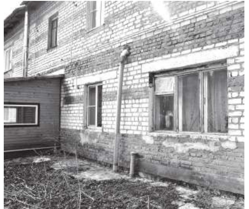
Стены старого дома давно ждут капитального ремонта
