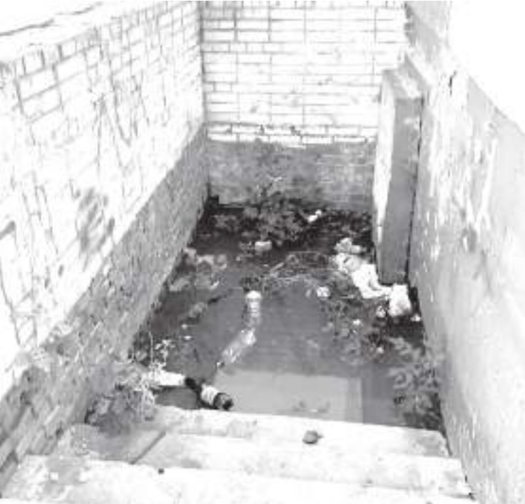
Подвал на Боровской, 11 в Балабанове начал наполняться водой 5 сентября 2023-го. До сих пор течь не устранена
