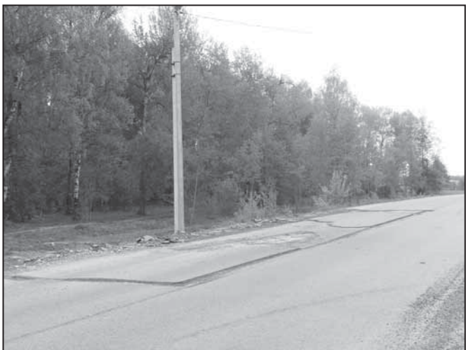
После зимы дорога стала разрушаться
