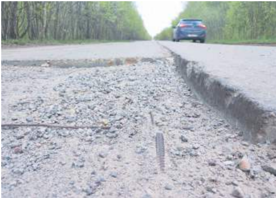
Дорога на деревню Федотово разбита большегрузами, направляющимися на территорию кирпичного завода
