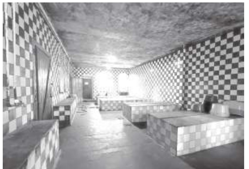
Пока здесь не появилась вентиляция, с плесенью борются сотрудники бани. Но через месяц от их трудов не остается и следа – потолок снова покрывается чернотой
