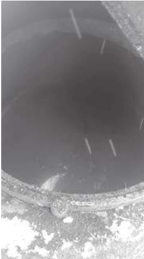
Колодцы центральной канализации «встали», и стоки ринулись в подвал
