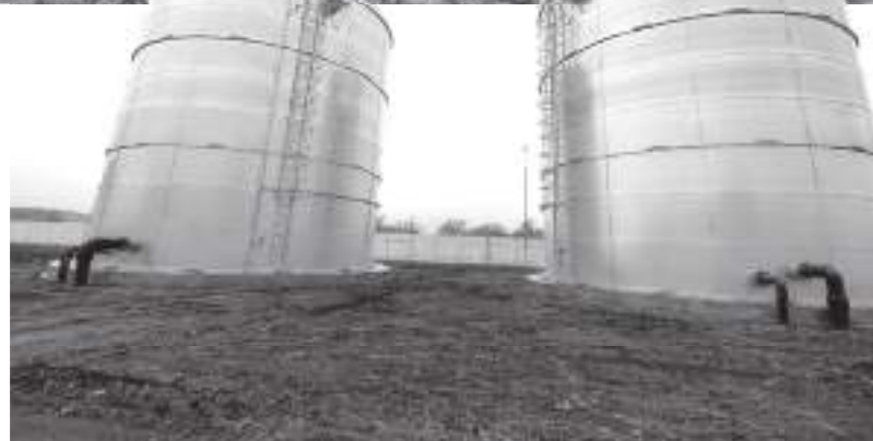
Новую станцию водоочистки построили с нуля
