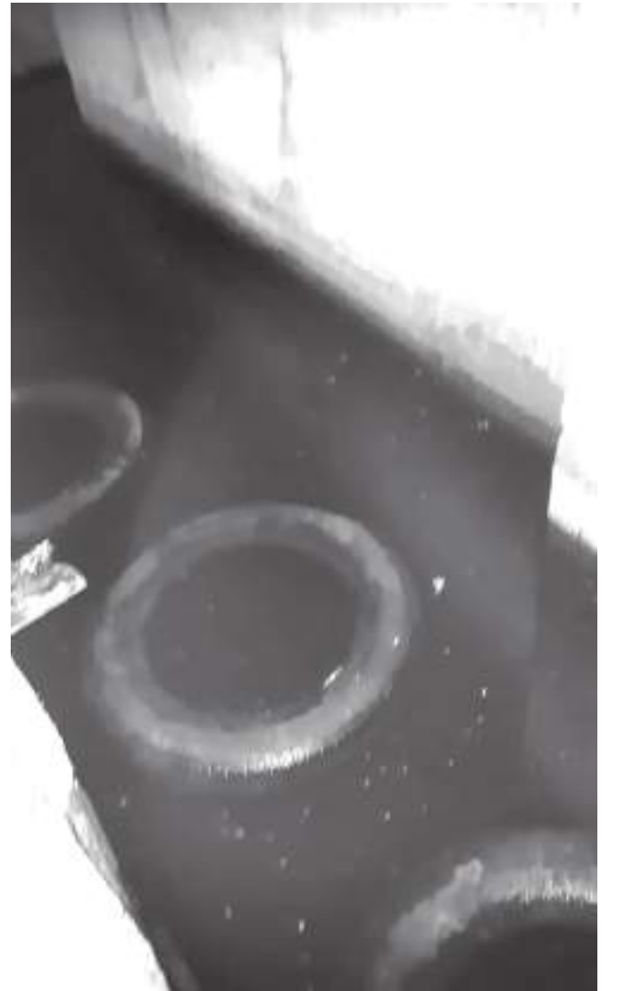
Подвал дома «утонул» в нечистотах
