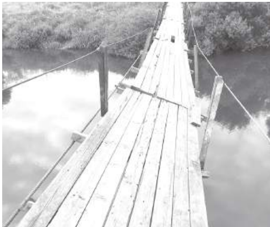
Навесной мост ждёт не ремонт, а снос
