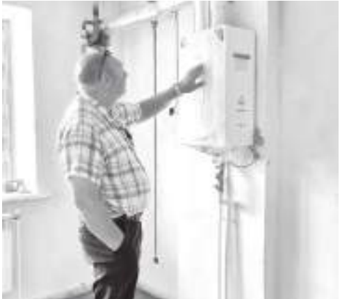
В каждой квартире уже установлено газовое оборудование
