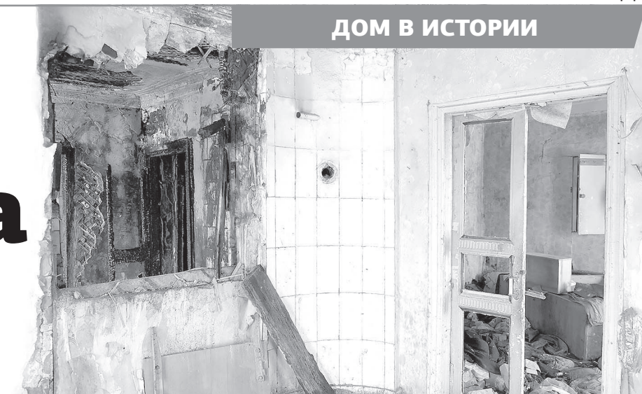
Интерьер 2-го этажа после пожара 2015 г.
