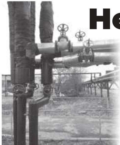
Сети и котельные требуют постоянного обновления
