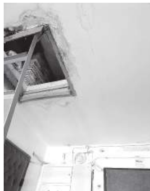
Жители Мичурина, 9 жалуются на «водопад» с потолка
