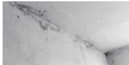
Черная плесень стала постоянным спутником жильцов этого дома. Депутат Александр ЛЫСИКОВ уверен, что проблема – в том числе своевременной очистке кровли от снега
