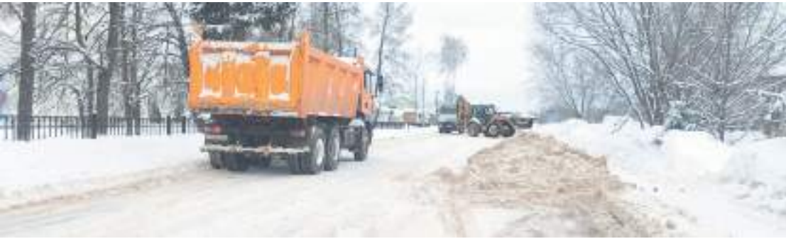
Очистка Центральной улицы в Совхозе «Боровский» проходит в плановом режиме
