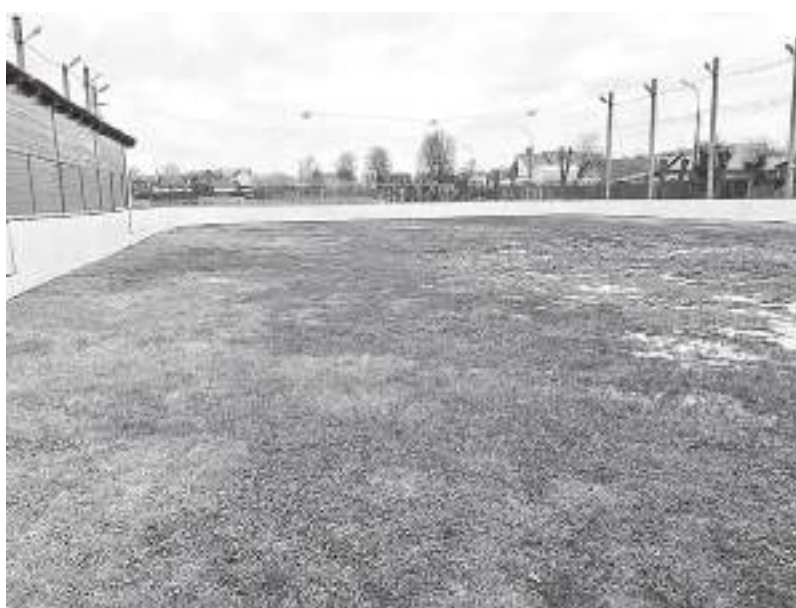
Прежде основание для заливки катка находилось в плачевном состоянии
