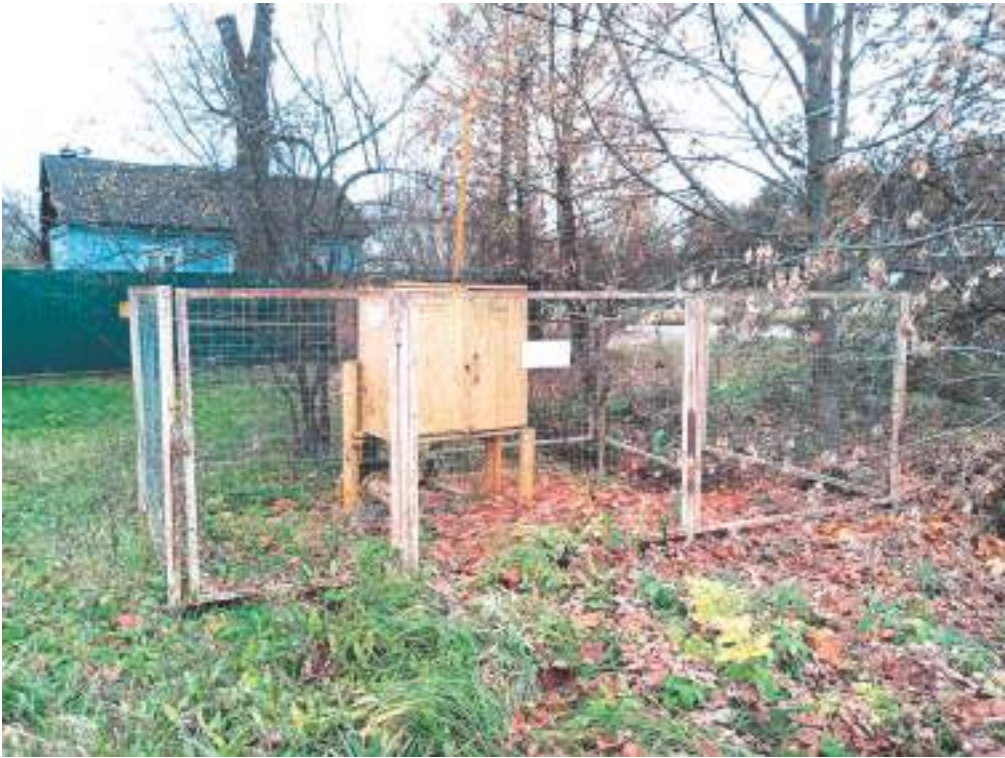
Газораспределительная станция в населенном пункте упрощает процесс подключения для абонентов
