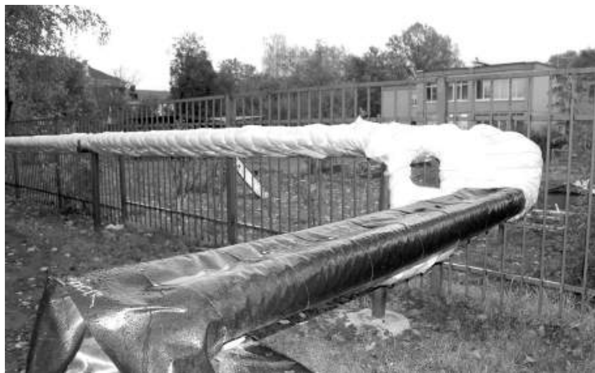
Наконец, начался запуск долгожданного отопления
