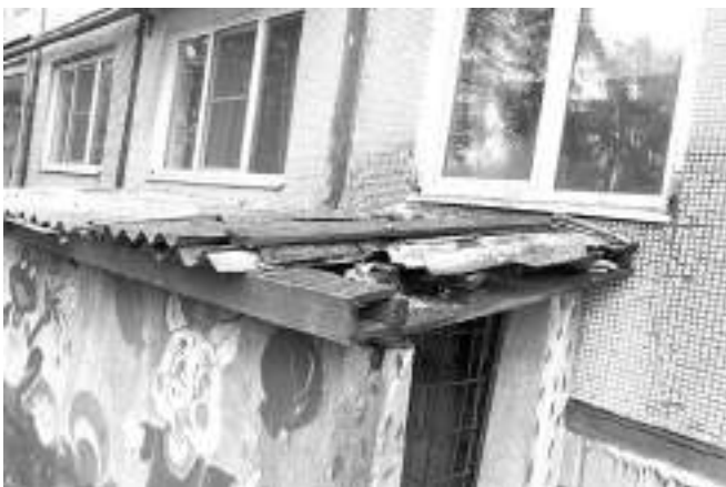
Деревянные перекрытия крыш подвальных помещений давно сгнили
