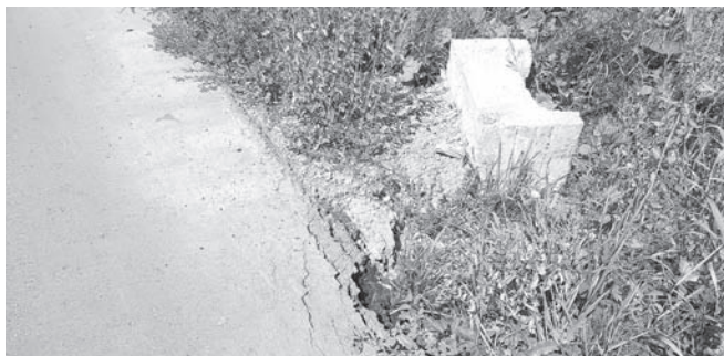
А кое-где дефекты и вовсе не заслужили внимания исполнителя работ. Фото улица Текстильная
