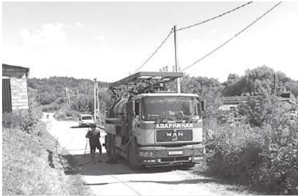
Трубопровод забился под речкой, поэтому на устранение засора у специалистов ушло два дня
