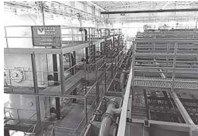
Один из проектов подобной станции, реализованный компанией ООО «Стройинжиниринг СМ»
