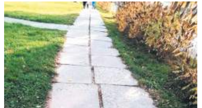
Так выглядела пешеходная дорожка, выложенная бетонными плитами, прежде
