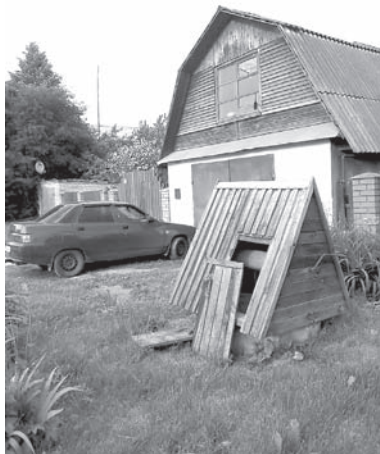
Дверь на оголовке сооружения на улице Пушкина сгнила
