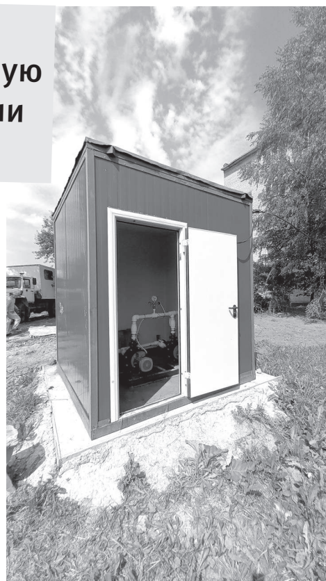
Станция повышения давления запущена в июле 2022 года
