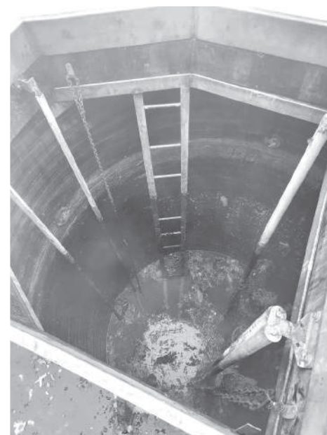
Насосные станции регулярно приходится прочищать из-за мусора, сбрасываемого в канализацию
